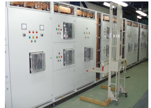
Equipamiento Terasaki en Neves
