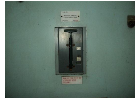
Interruptor antiguo AH16B en el cuadro
