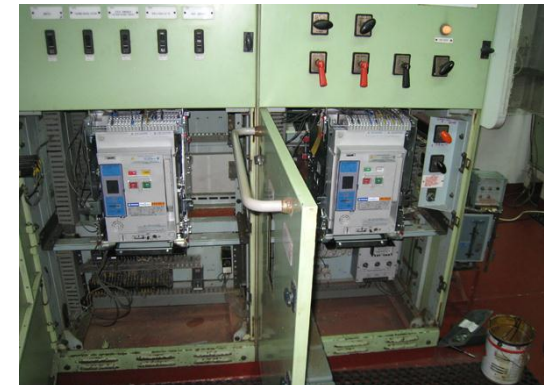
Nuevo TemPower2 instalado
