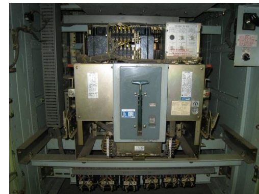
Interruptor antiguo AH16B en el cuadro
