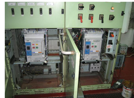
Nuevo TemPower2 instalado
