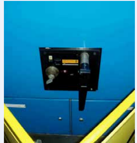
ACB DA 4000 : Accès restreint en raison de déclenchements intempestifs
