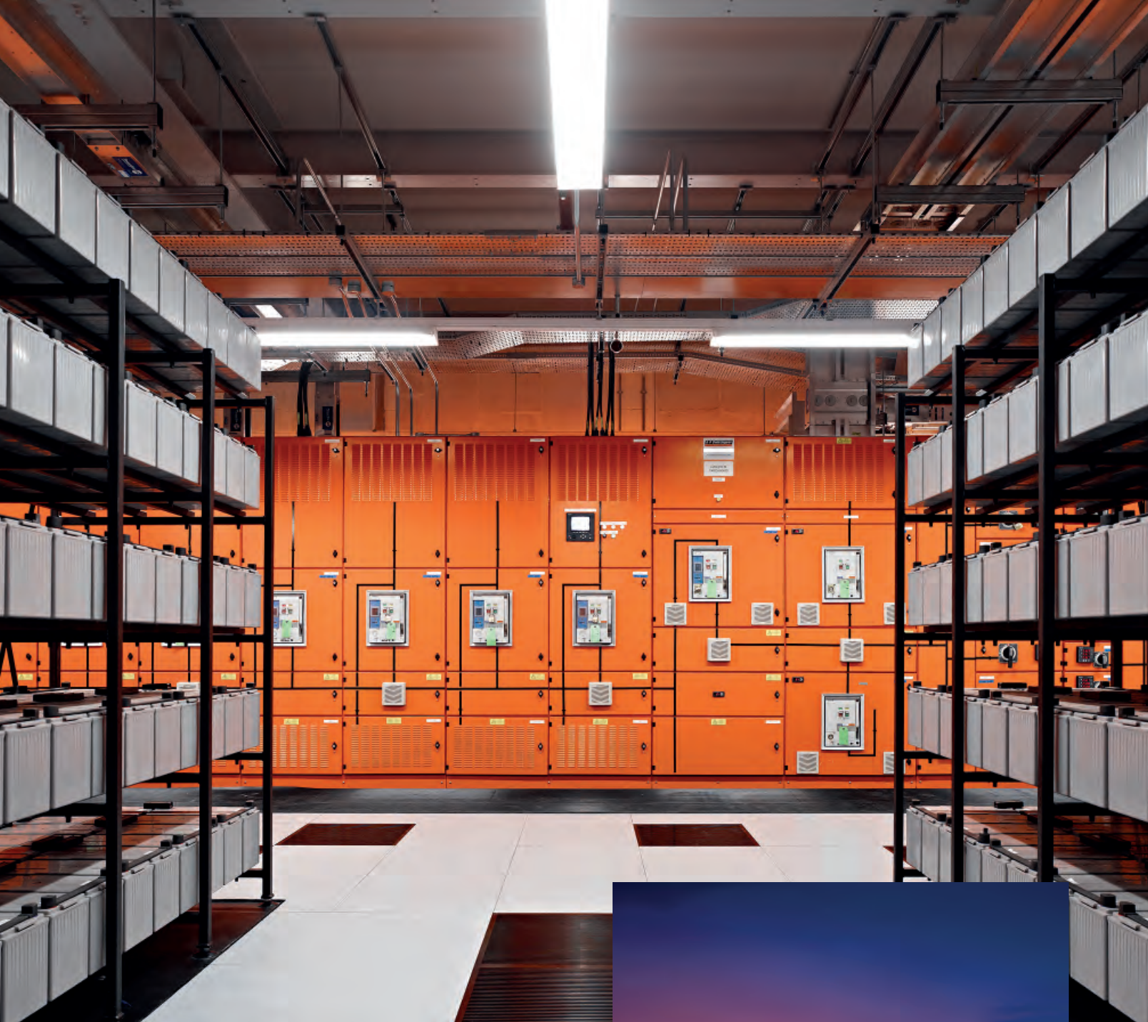
[Telehouse Data Centre, Londyn. 199 wyłączników mocy TemPower2, 423 wyłączniki kompaktowe TemBreak2.]
