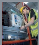
Drift av anläggning
