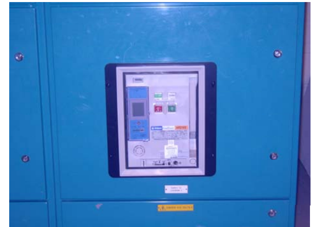
Retrofit ACB TemPower 2
