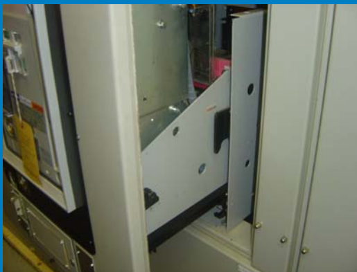
ACB sustituido en bastidor rodante original
