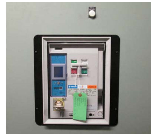
Después: Retrofit ACB, relé de protección con pantalla LCD
