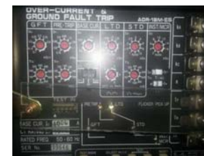
Antes: Relé de protección obsoleto
